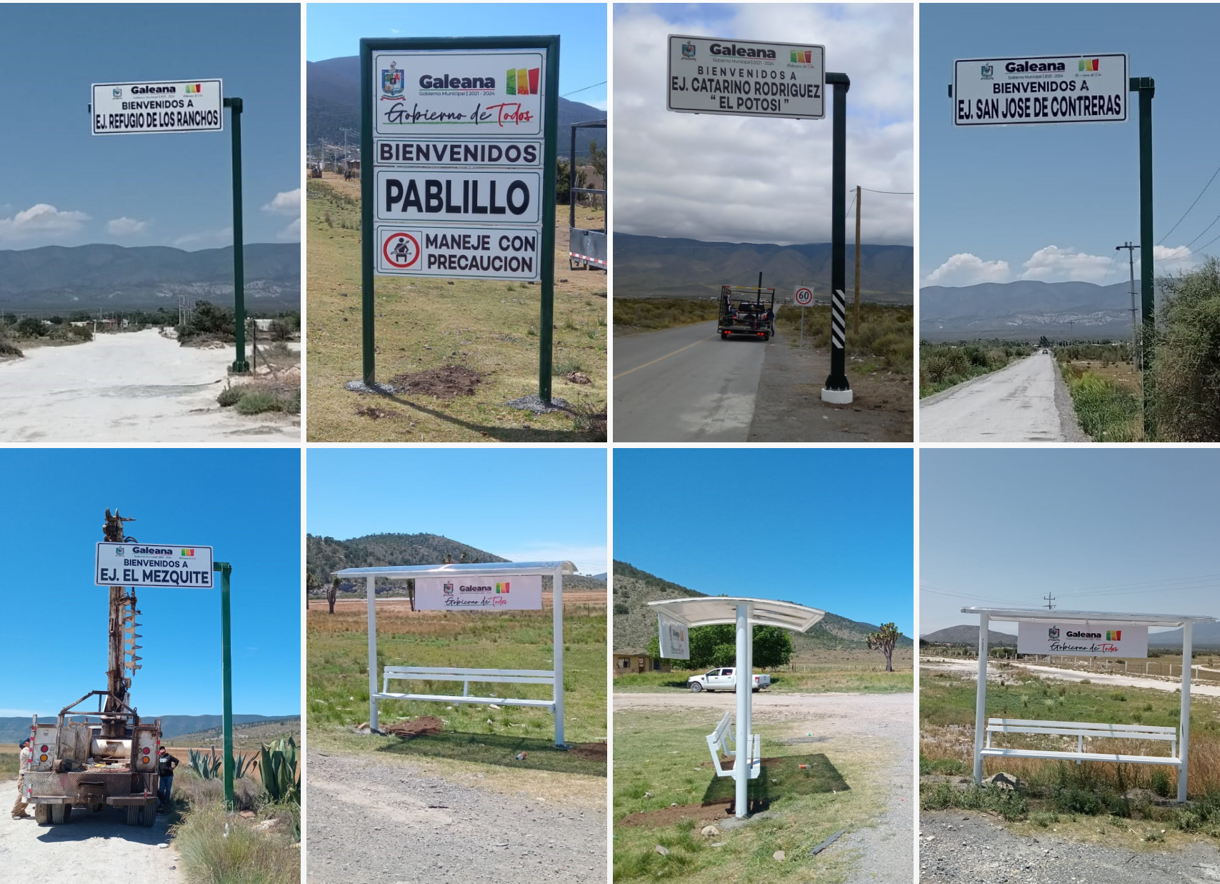
Instalación de Señalamientos en Cabecera Municipal, Vialidades Principales y Comunidades de Galeana
